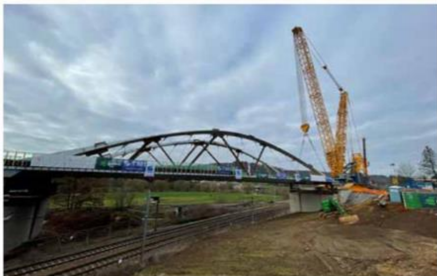
Gezien de configuratie van het kunstwerk en de beschikbare ruimte werd er geopteerd voor een hybride-installatiemethode: enerzijds met een rupskraan van 1100 ton, anderzijds met een systeem van zelfrijdende modulaire trailers (SPMT).
