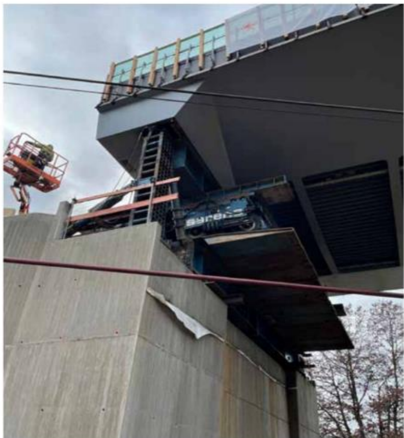
Wanneer de constructie op haar definitieve positie geschoven was, bevonden de SPMT's zich ergens boven het landhoofd en op een kleine tijdelijke brug die door de firma SARENS was geïnstalleerd om de laatste meters te overbruggen.
