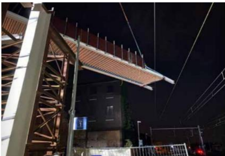
La pose la partie enjambant les voies s'est déroulée de nuit un week-end de mai, lors d'une interruption du trafic programmée par Infrabel.
