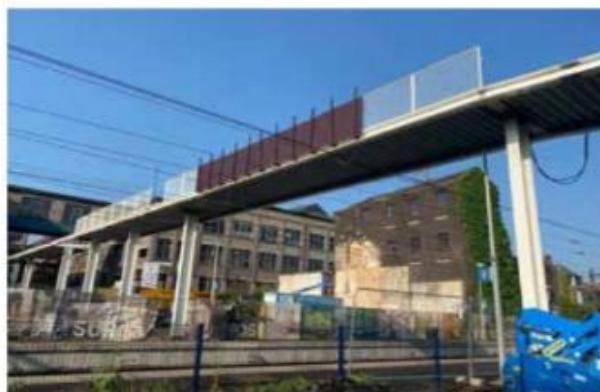
Pour éviter que les poutres ne descendent trop près des caténaires une fois le tablier coulé, la contreflèche appliquée en atelier devait être maintenue jusqu'au bétonnage.
